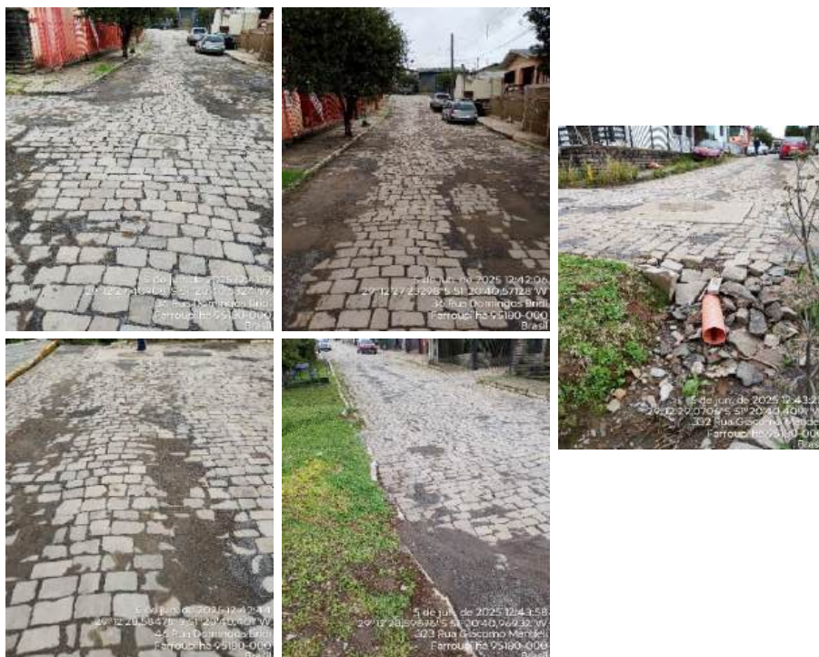
Figura 9 – Registro fotográfico Rua Domingos Bridi.
