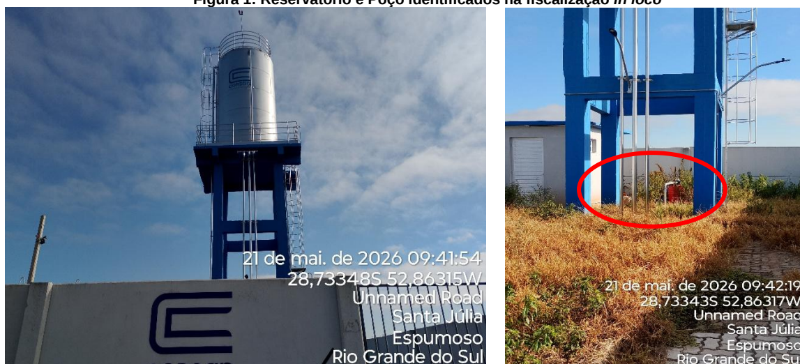
Figura 1: Reservatório e Poço identificados na fiscalização in loco
