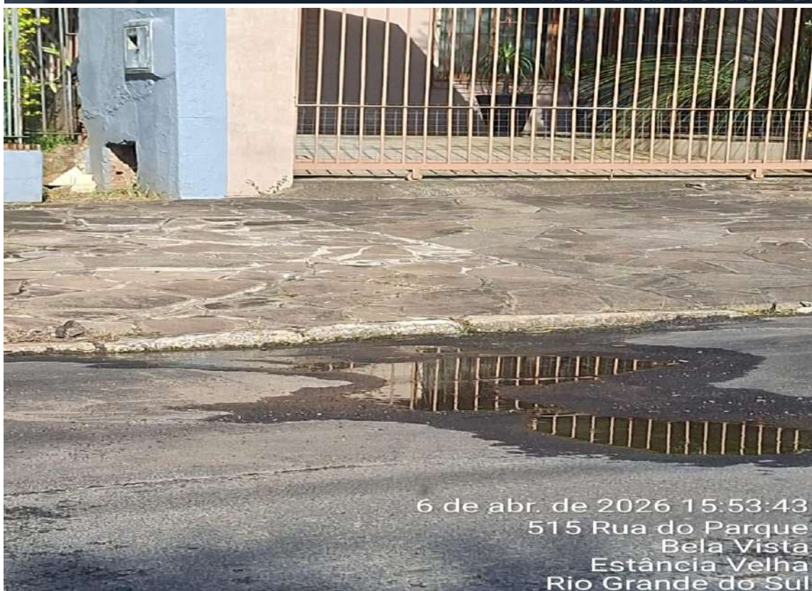
Local com vazamento
