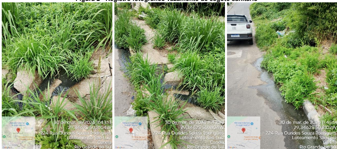
Figura 2 - Registro fotográfico vazamento de esgoto sanitário
