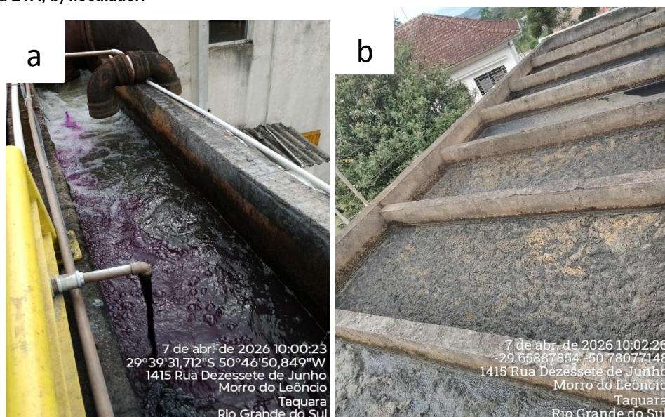
Figura 01: Identificação da adição de carvão ativado e permanganato de potássio na ETA de Taquara/RS. a) entrada de água bruta da ETA; b) floculador.
