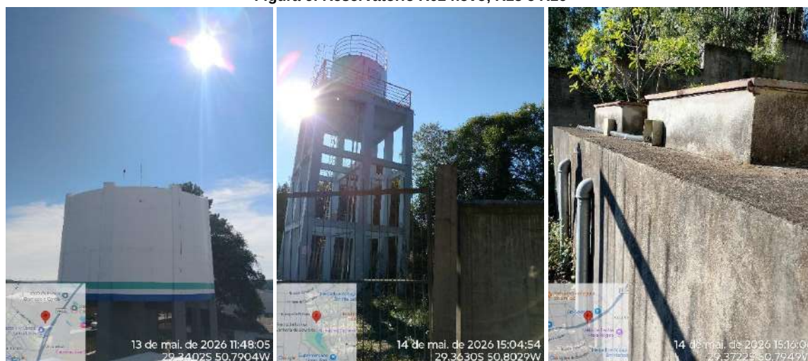
Figura 6: Reservatório R02 novo, R15 e R16
