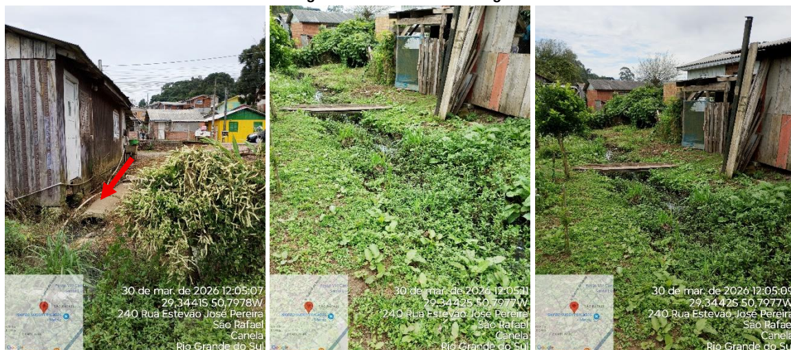
Figura 2: Escoamento de esgoto a céu aberto
