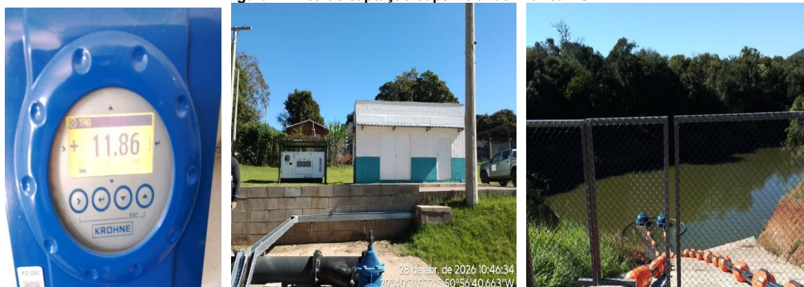
Figura 1: Área de captação superficial de Araricá/RS.
