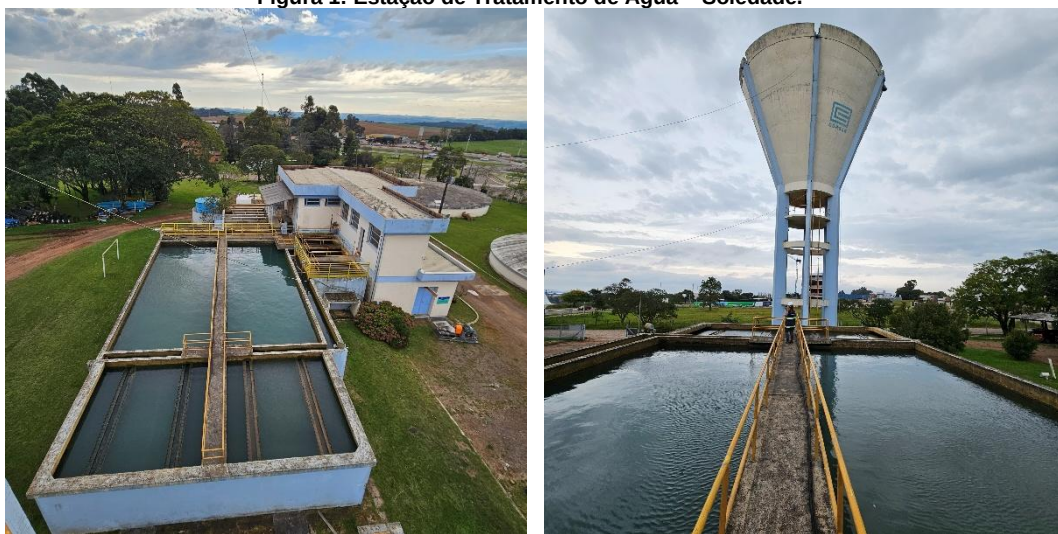
Figura 1: Estação de Tratamento de Água – Soledade.
