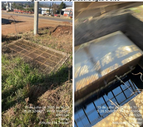
Figura 3: Caixa separadora água e óleo
