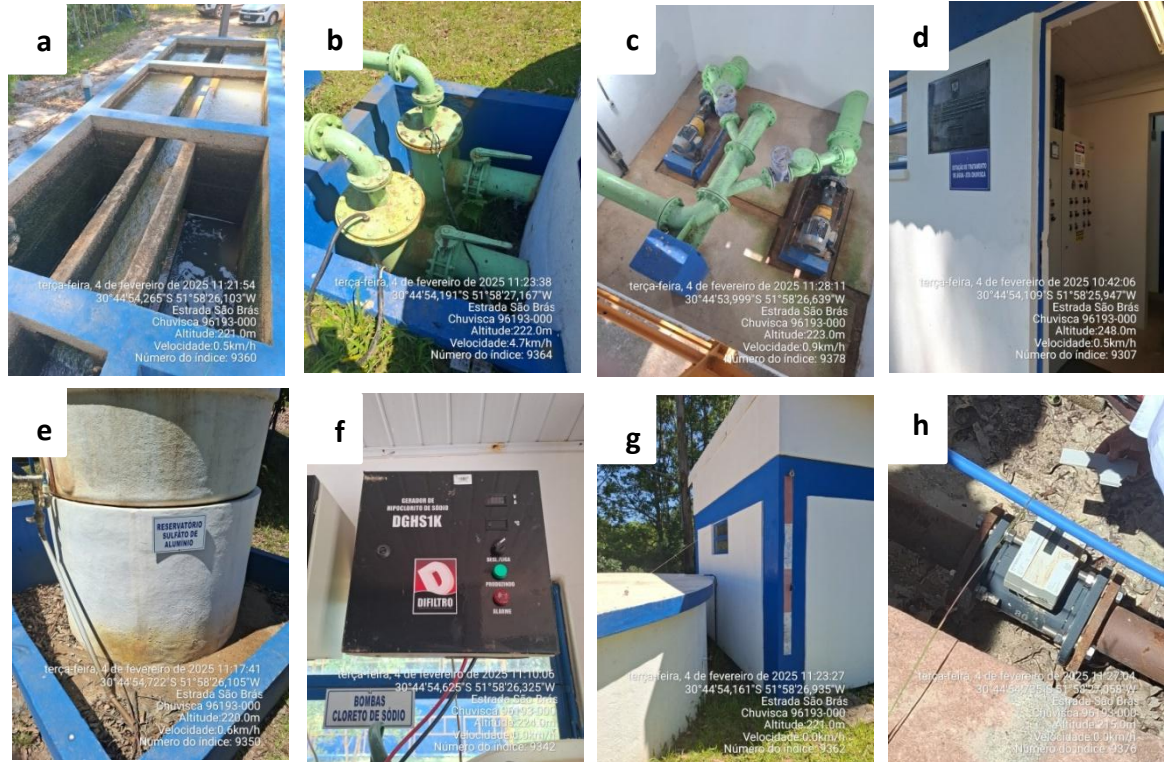
Figura 02: Área da ETA de Chuvisca/RS. a) Vista superior do bloco hidráulico; b) Estação elevatória de água tratada para distribuição; c) Estação elevatória de água de lavagem de filtros; d) Entrada do laboratório operacional; e) Tanque de sulfato de alumínio; f) Equipamento Hidrogeron; g) Reservatório apoiado de distribuição e h) Macromedidor instalado no pátio da ETA.
