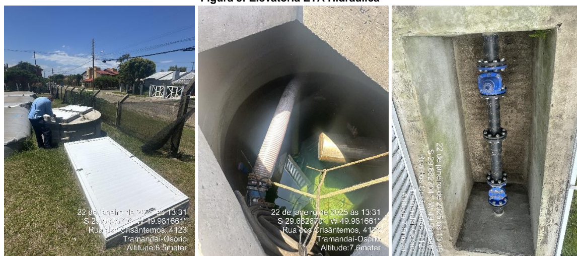
Figura 5: Elevatória ETA Hidráulica
