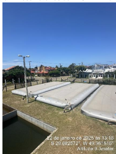
Figura 4: Reservatórios de PVC ETA Hidráulica
