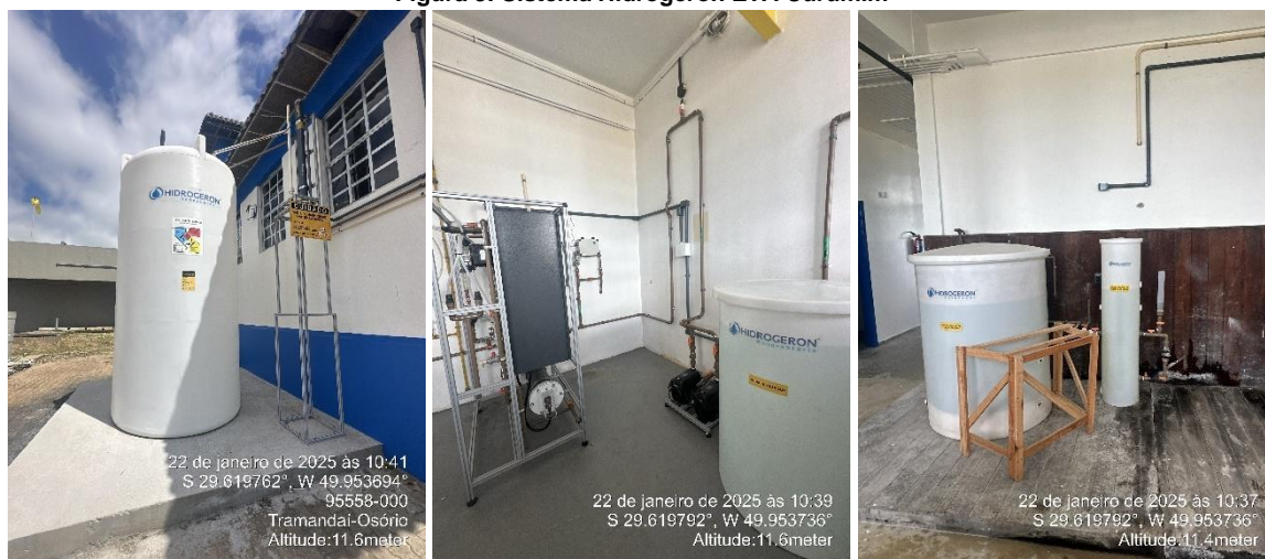
Figura 3: Sistema Hidrogeron ETA Curumim
