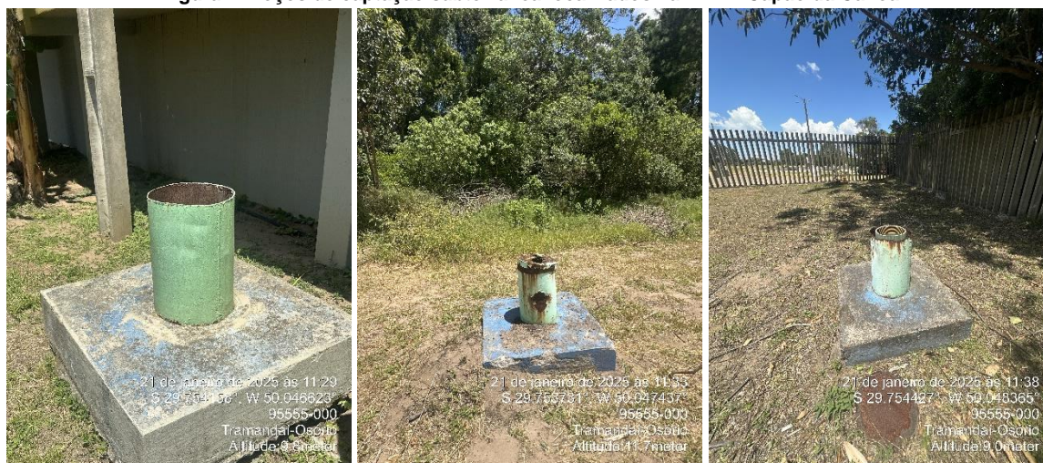
Figura 2: Poços de captação subterrânea localizados na ETA-II Capão da Canoa
