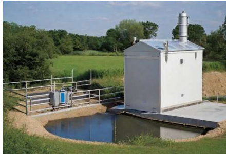
Figura 46 – Ilustração da estação elevatória da microdrenagem.
