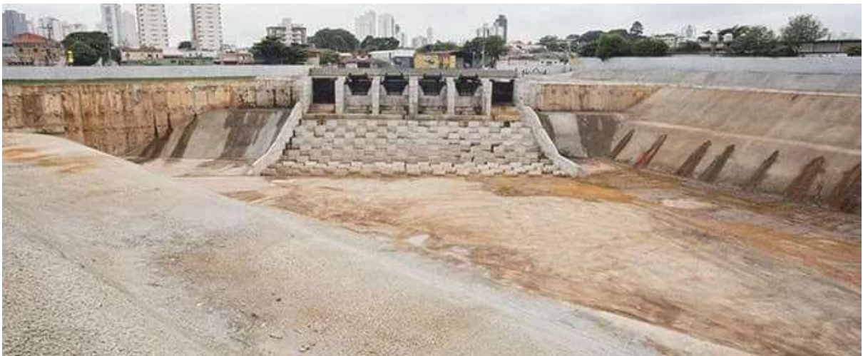
Figura 63 – Transporte das águas das chuvas para o piscinão.
