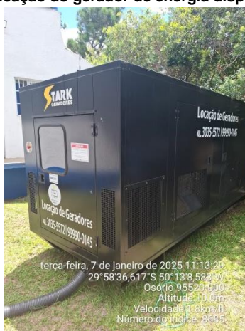
Figura 1 – Identificação do gerador de energia disponível na unidade.
