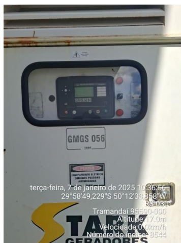
Figura 5: Gerador de energia elétrica localizado na área da ETA.
