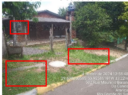
Figura 1 - Ausência de caixa de passagem em calçada, n. 496 Coordenadas Geográficas: 29°36'29.74" S 50°55'30.58" W
