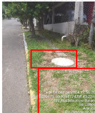
Figura 2 - Ausência de caixa de passagem em calçada. Coordenadas Geográficas: 29°36'29.90" S 50°55'30.64" W
