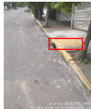
Figura 3 - Ausência de caixa de passagem em calçada. Coordenadas Geográficas: 29°36'29.47" S 50°55'30.59" W
