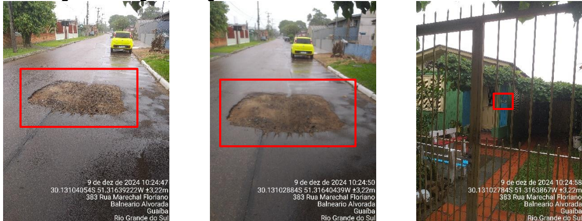
Figura 29 - Registro fotográfico evidência 29 - Rua Marechal Floriano, nº 15
