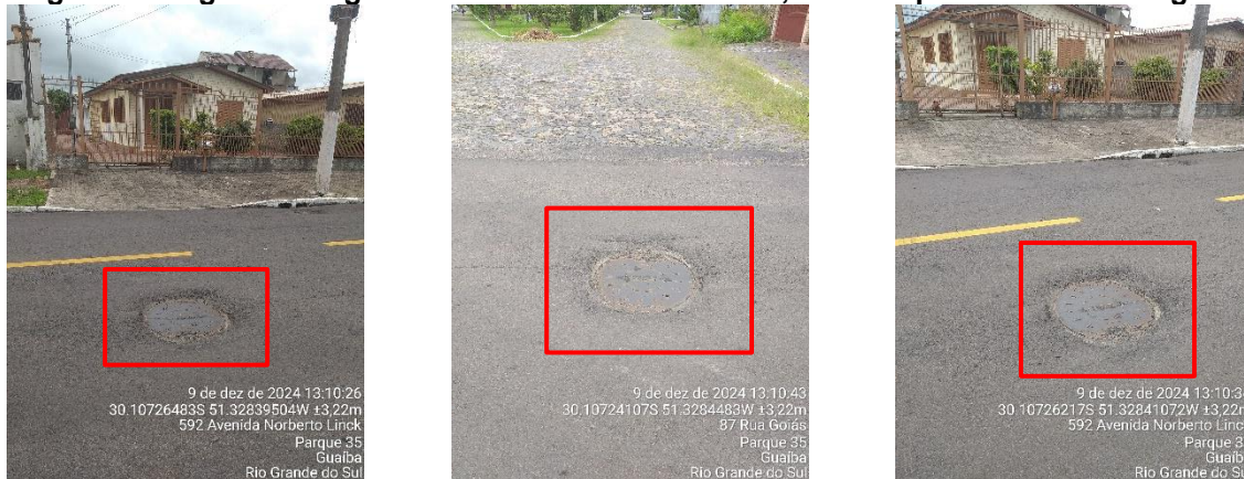
Figura 5 - Registro fotográfico evidência 5 - Rua Goiás, n. 79 esquina com Rua Alagoas
