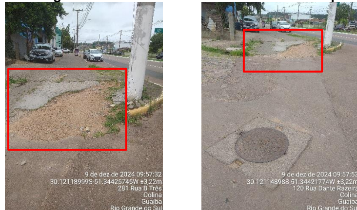
Figura 16 - Registro fotográfico evidência 16 - Av. Castelo Branco esquina Rua Luiz Green
