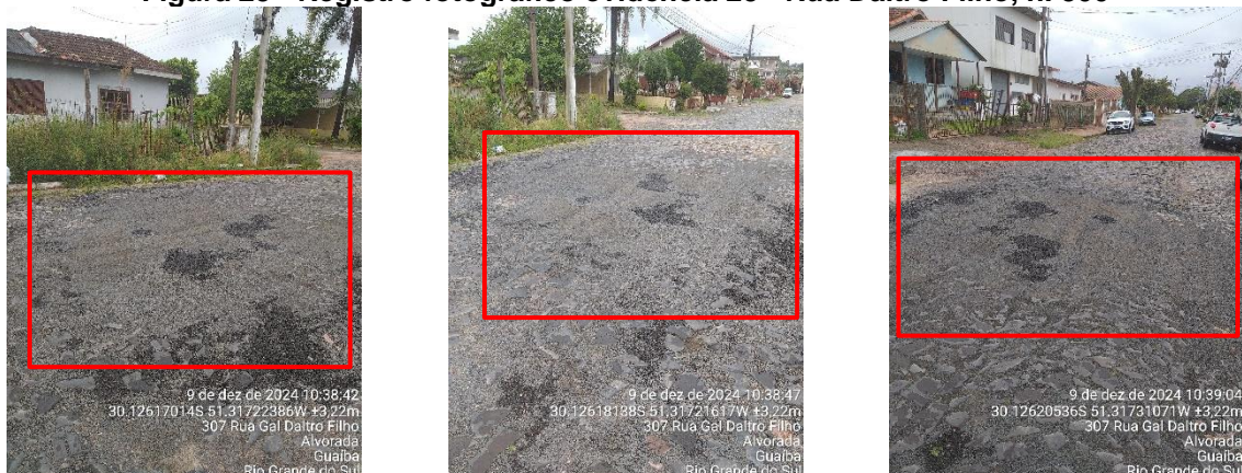
Figura 25 - Registro fotográfico evidência 25 - Rua Daltro Filho, n. 300
