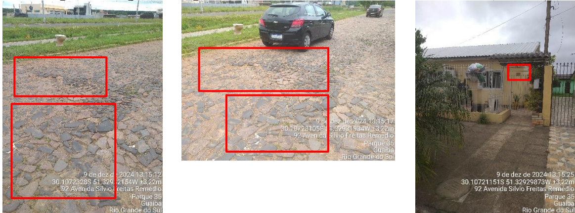
Figura 2 - Registro fotográfico evidência 2 - Rua Silvio Freitas Remédio, n. 92
