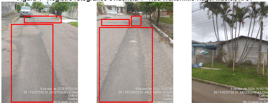
Figura 4 - Registro fotográfico evidência 4 - Rua Waltormilo Hagel Maciel, n. 51
