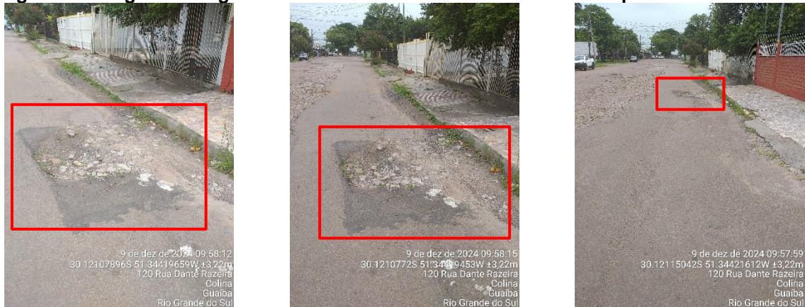
Figura 15 - Registro fotográfico evidência 15 - Av. Castelo Branco esquina Rua Luiz Green
