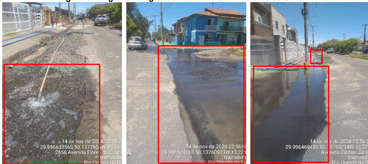
Figura 3 - Registro fotográfico evidência 3 - Av. Flores da Cunha
