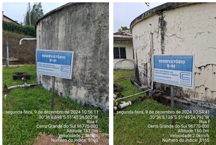
Figura 4 – Reservatórios de abastecimento de água em Cerro Grande Do Sul.
