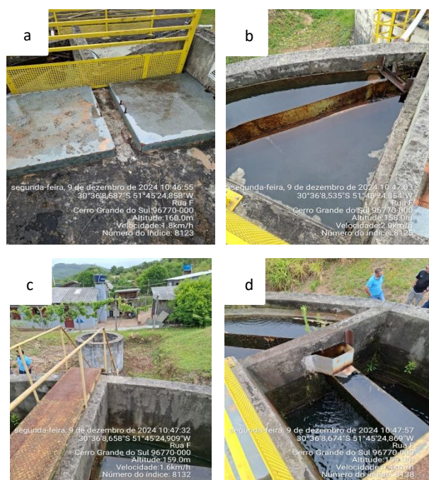
Figura 2: bloco hidráulico da ETA de Cerro Grande Do Sul. a) Vista das tampas de inspeção da câmara de mistura; b) Vista de um dos filtros; c) Escada de acesso ao bloco hidráulico; e d) Vista dos filtros descendentes.
