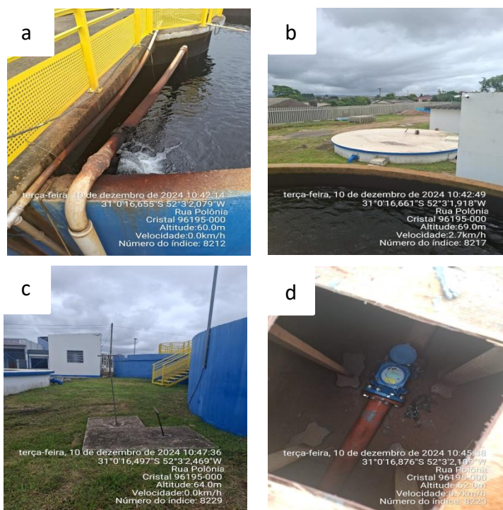
Figura 02: Identificação da ETA de Cristal/RS. a) entrada de água bruta; b) vista em perspectiva do bloco hidráulico e Reservatório R-01; c) vista lateral de bloco hidráulico; d) macromedidor de entrada de água bruta no sistema.
