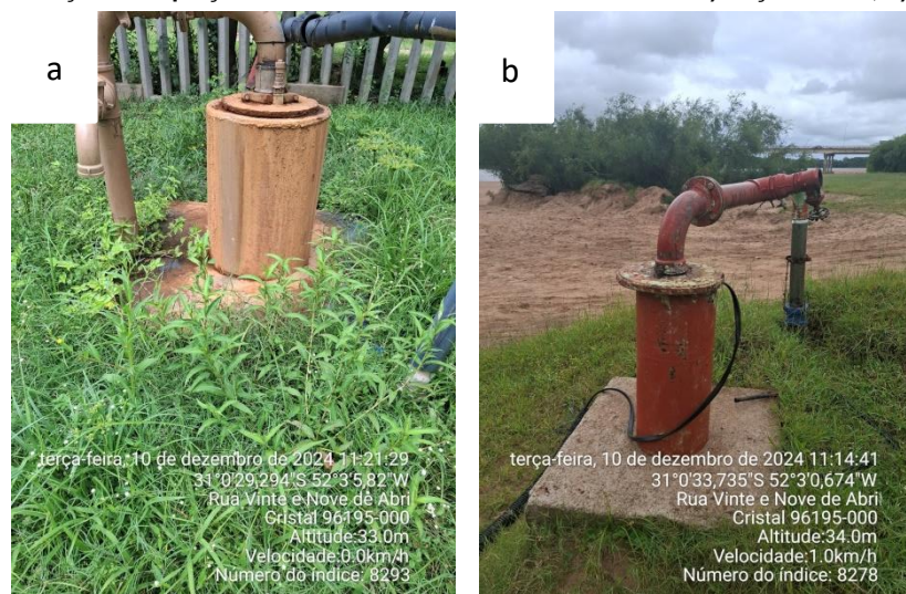
Figura 01: Poços de captação subterrânea localizados em Cristal/RS. a) Poço CRS 03; b) Poço CRS 04.
