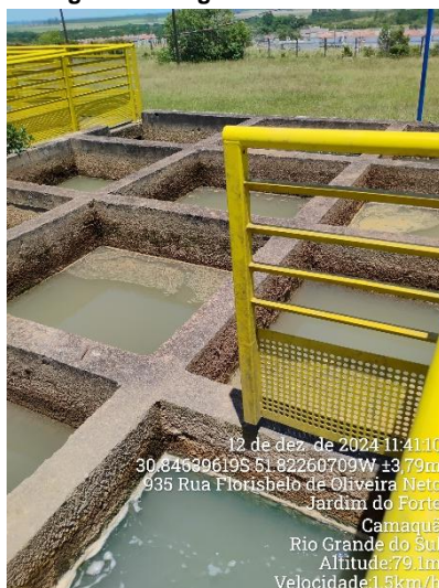
Figura 1 –Registros fotográficos da ETA de Camaquã.
