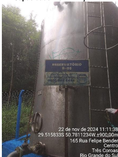
Figura 19 - Reservatório R3. Capacidade: 20 m 3 - Aço Inox
