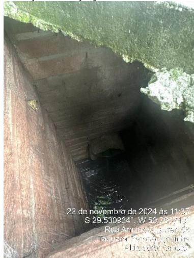
Figura 45 - ETE compacta. Tampa de inspeção saída efluente.
