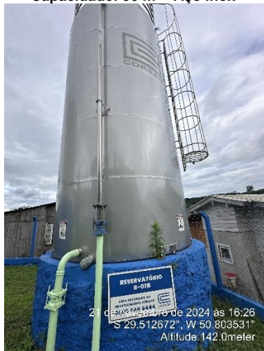
Figura 25 - Reservatório R7B. Capacidade: 50 m 3 - Aço Inox
