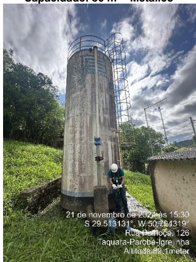
Figura 22 - Reservatório R6. Capacidade: 50 m 3 - Metálico
