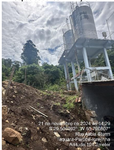
Figura 28 - Reservatório R11. Capacidade: 30 m 3 - Aço Inox
