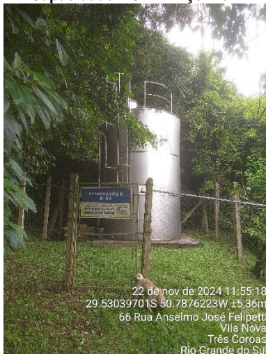
Figura 20 - Reservatório R4. Capacidade: 20 m 3 - Aço Inox
