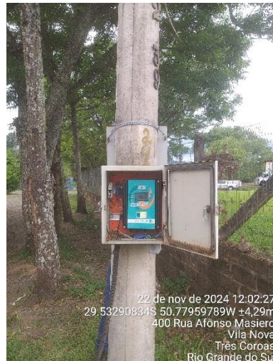
Figura 39 - Macromedidor Adutora nova DN 300.
