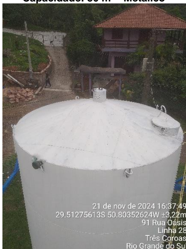
Figura 23 - Reservatório R7. Capacidade: 50 m 3 - Metálico
