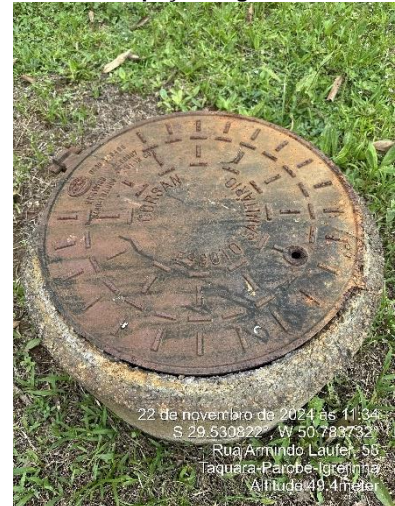
Figura 46 - ETE compacta. Caixa de inspeção Esgoto Sanitário.
