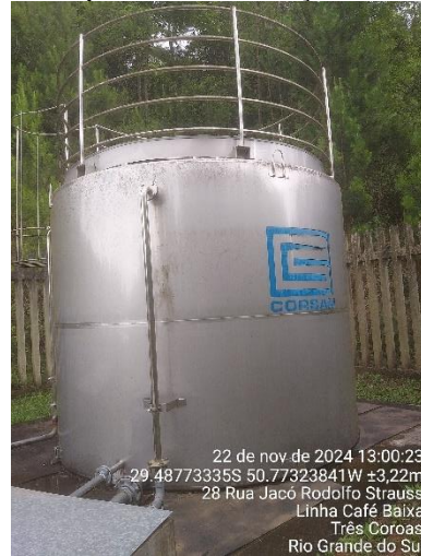
Figura 35 - Reservatório R17. Capacidade: 20 m 3 - Aço Inox
