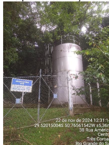
Figura 21 - Reservatório R5. Capacidade: 50 m 3 - Aço Inox
