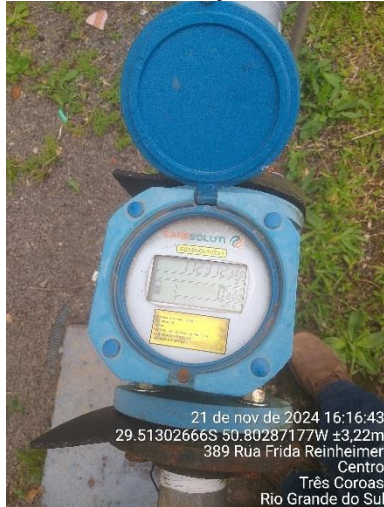
Figura 36 - Macromedidor Junto c/ Poço - 01.
