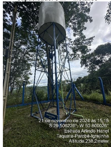
Figura 27 - Reservatório R10. Capacidade: 5 m 3 - Metálico
