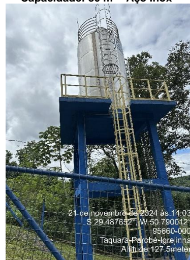
Figura 33 - Reservatório R15. Capacidade: 30 m 3 - Aço Inox
