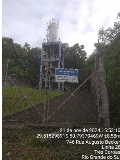
Figura 34 - Reservatório R16. Capacidade: 20 m 3 - Aço Inox
