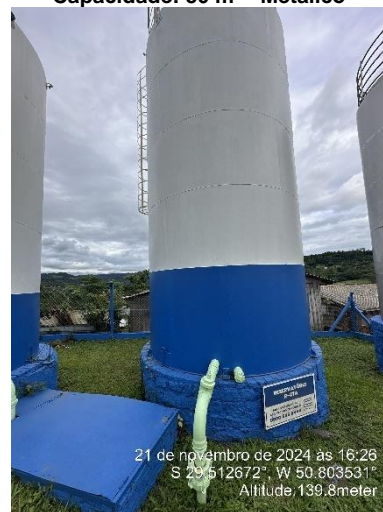
Figura 24 - Reservatório R7A. Capacidade: 50 m 3 - Metálico
