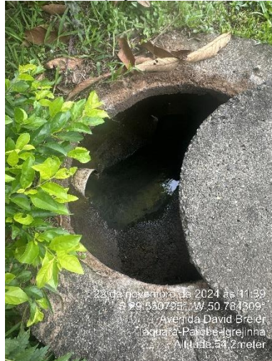
Figura 42 - ETE compacta. Caixa de inspeção antecede fossa.
