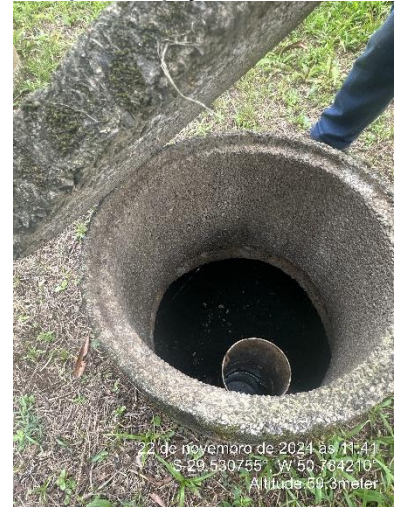
Figura 43 - ETE compacta. Tampa de inspeção fossa coletiva.
