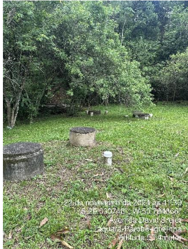
Figura 41 - ETE compacta. Vista Geral da ETE compacta.
