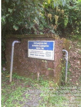
Figura 13 Sistema de Bombeamento EBAT - 10 (Booster) - Serra Grande.
