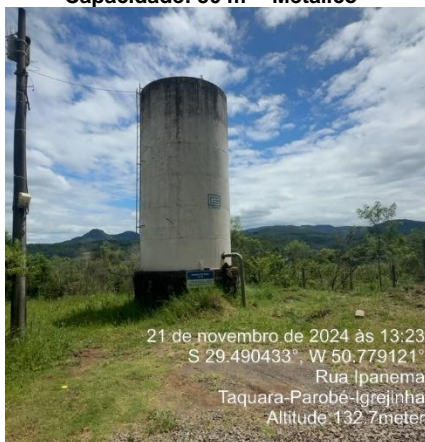
Figura 32 - Reservatório R13. Capacidade: 50 m 3 - Metálico
