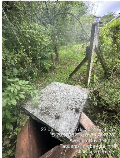
Figura 44 - ETE compacta. Tampa de inspeção saída efluente.
