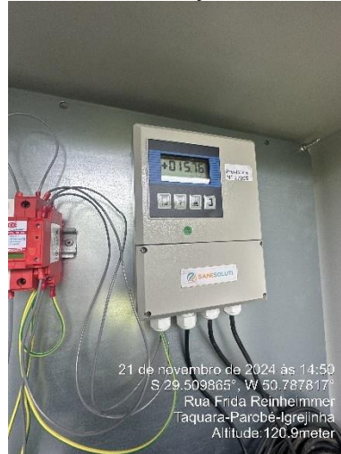
Figura 37 - Macromedidor Junto c/ Poço - 02.
