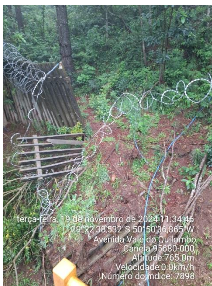
Figura 9: Movimentação de massa na área da ETE Reserva da Serra.
