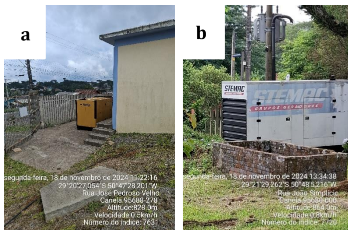
Figura 6: Geradores de energia elétrica instalados nas ETA em Canela/RS. a) Gerador localizado na ETA II; b) Geradores localizado na ETA I.
