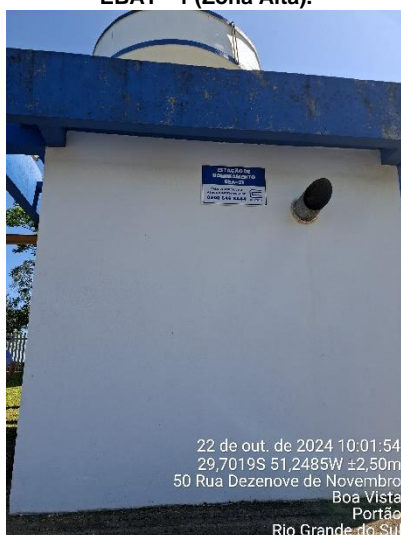
Figura 01 - Sistema de Bombeamento. EBAT - 1 (Zona Alta).
