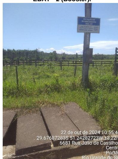
Figura 02 - Sistema de Bombeamento Compacto. EBAT - 2 (Booster).
