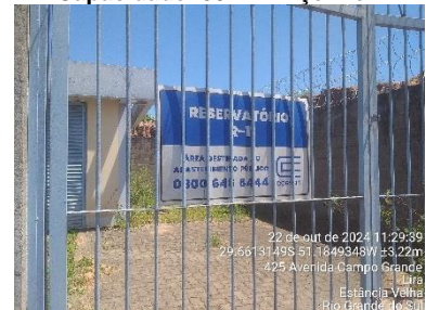
Figura 26 - Reservatório R11. Capacidade: 30 m³ - Aço Inox
