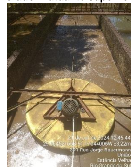
Figura 38 - ETE Nova Estância. Aerador flutuante superficial
