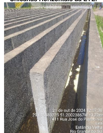
Figura 41 - ETE Estância Velha. Chicanas Horizontais da ETE.
