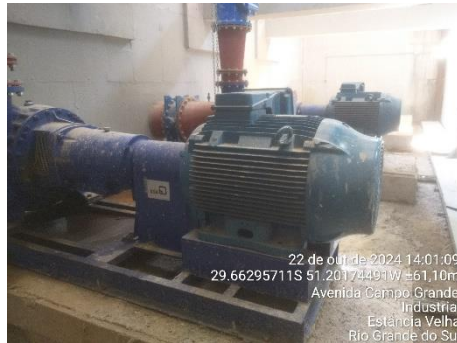
Figura 43 - EBE-01. Sistema de bombeamento dos efluentes.
