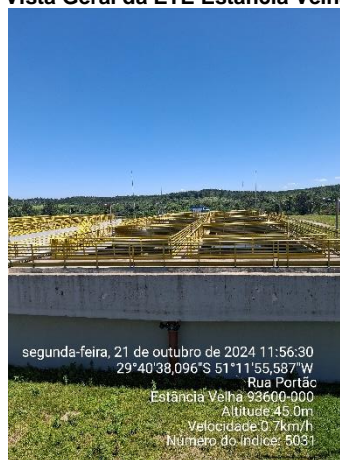
Figura 40 - ETE Estância Velha. Vista Geral da ETE Estância Velha
