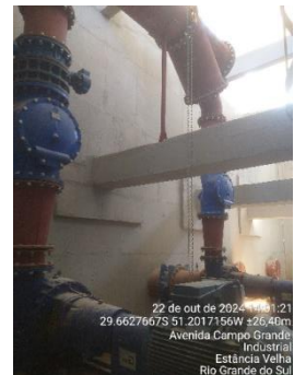
Figura 44 - EBE-01. Tubulação DN 400 em FF.
