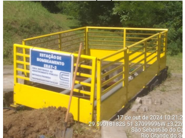
Figura 12 - Sistema de Bombeamento Compacto. EBAT - 2 (ETA).
