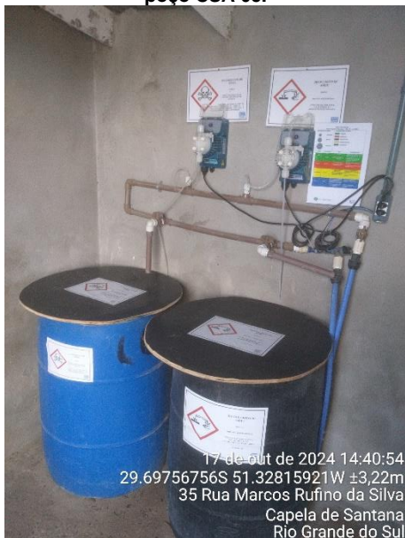
Figura 9 - Interior da Casa de Química simplificada do poço CSA 05.
