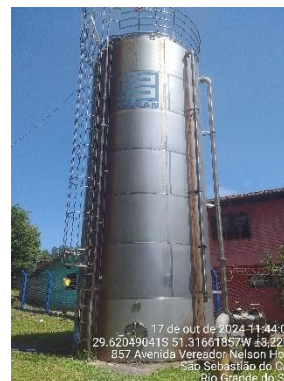
Figura 17 - Reservatório R6 Capacidade: 100 m³ - Inox
