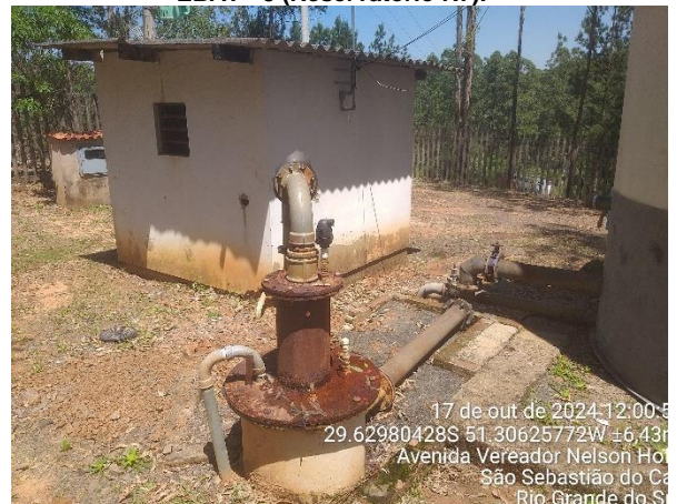
Figura 14 - Sistema de Bombeamento Compacto. EBAT - 5 (Reservatório R7).
