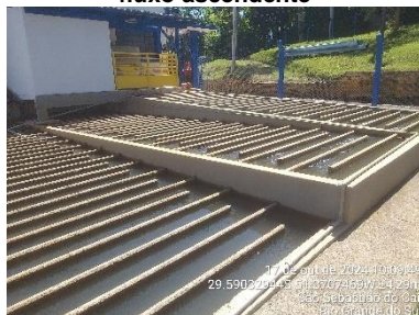
Figura 6 - Floculador hidráulico de fluxo ascendente
