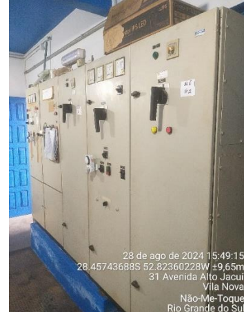
Figura 13 - Recalque (REC). Conjunto de acionamento das Bombas.
