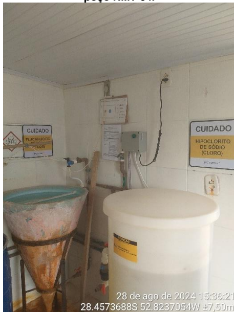
Figura 10 - Interior da Casa de Química simplificada do poço NMT 04.
