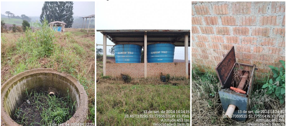
Figura 20 – Unidade de transbordo.
