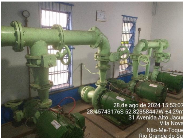
Figura 12 - Recalque (REC) - Grupo de Bombas.
