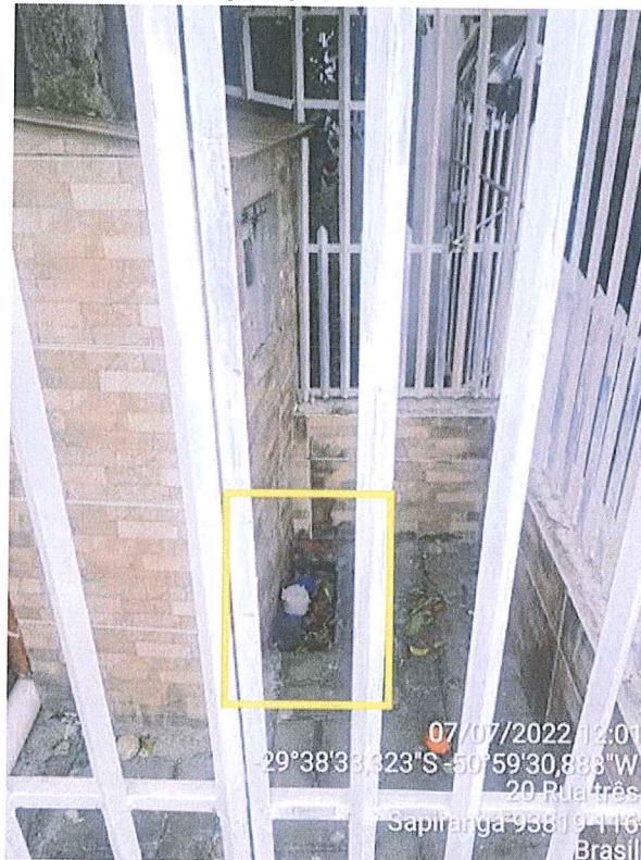
Figura 4 - Registro fotográfico a posição exata onde o hidrômetro está instalado.
