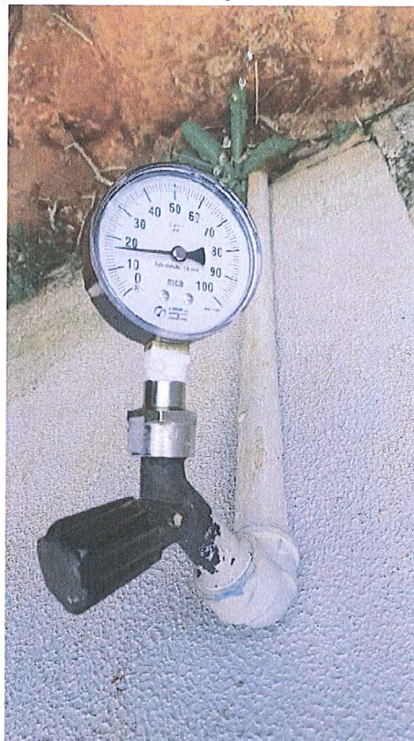
Figura 3 - Registro fotográfico medição de pressão realizada dentro da propriedade.
