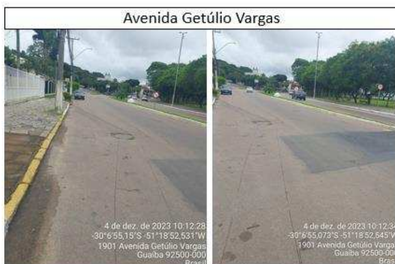
Figura 12 – Registros fotográficos na Avenida Getúlio Vargas.
