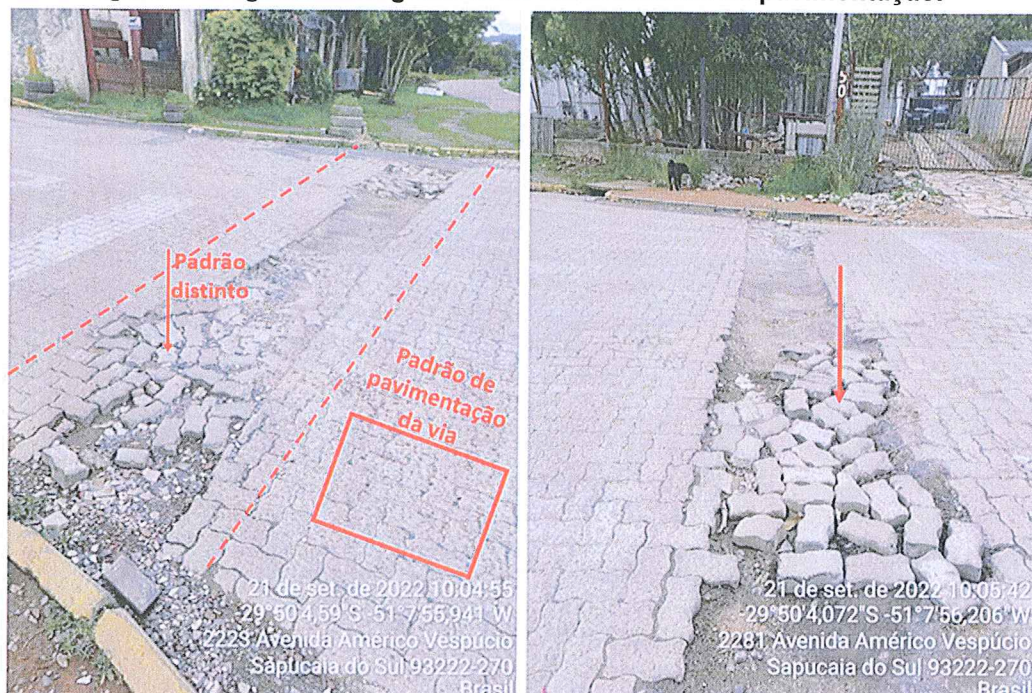
Figura 3 - Registros fotográficos de deformidades na pavimentação.
