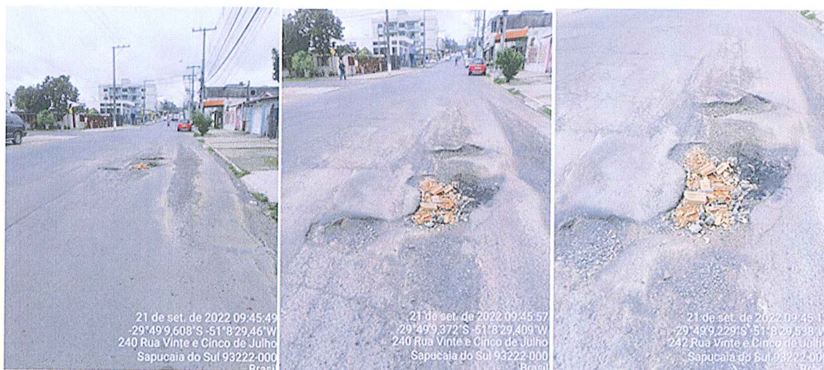
Figura 2 - Registros fotográficos de deformidades na pavimentação.
