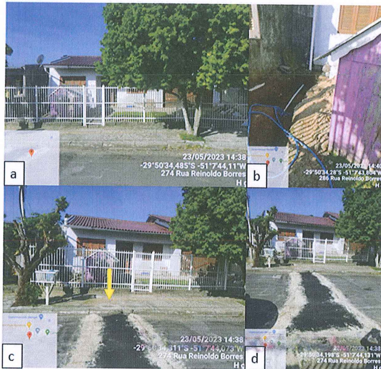
Figura 2 – Registro fotográfico da evidência de caixa de ligação: a) Vista da frente do imóvel; b) Vista da obra inacabada do morador para ligação de esgoto; c) Vista do posicionamento da caixa de esgoto no calçamento em frente ao imóvel; d) Vista da ligação entre as caixas de esgoto entre os dois lados da rua.
