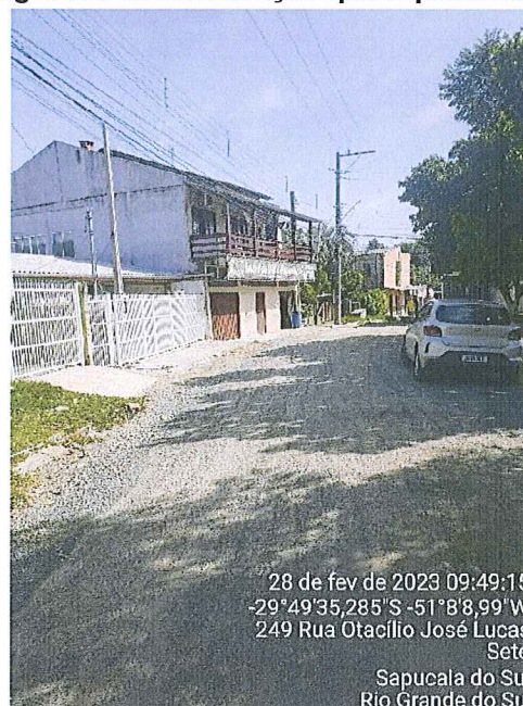
Figura 2 – Registro fotográfico da fiscalização que representa a situação atual da via.
