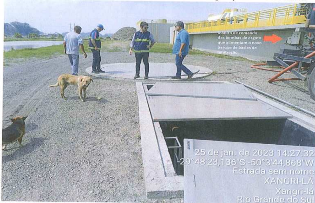
Figura 10 - Vista geral do sistema de bombeamento de esgoto para as novas bacias.
