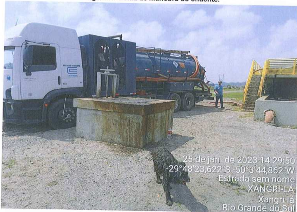
Figura 8 - Caixa de manobra do efluente.
