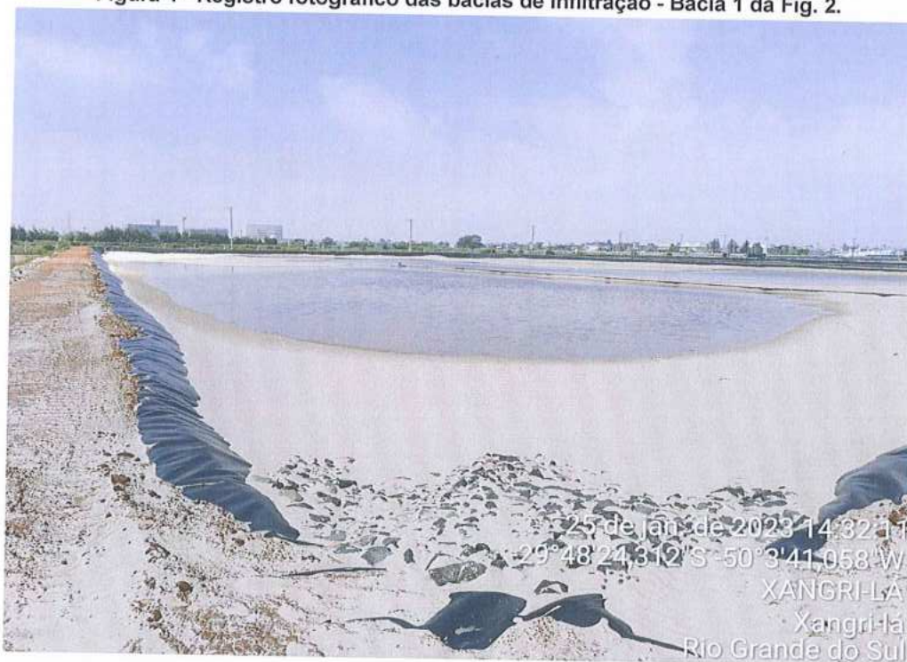
Figura 4 - Registro fotográfico das bacias de infiltração - Bacia 1 da Fig. 2.
