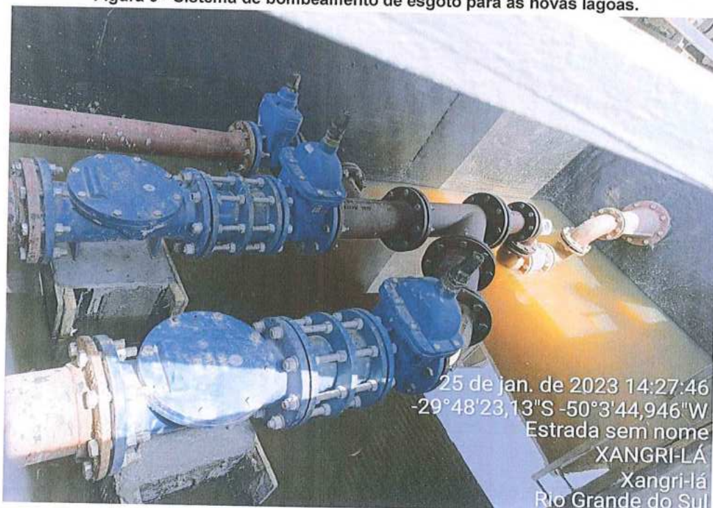
Figura 9 - Sistema de bombeamento de esgoto para as novas lagoas.
