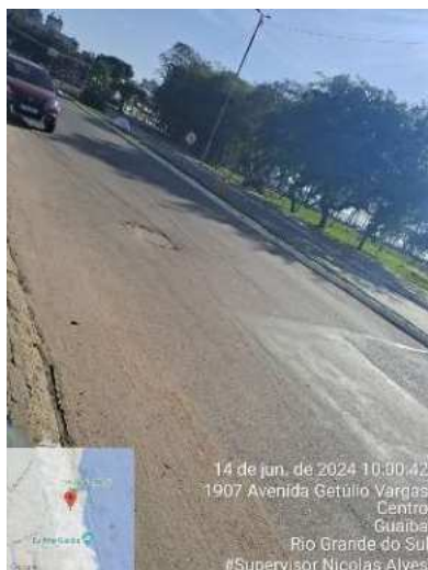
Imagem 08, Vistoria realizada no dia 14/06/2024 na Avenida Getúlio Vargas.
