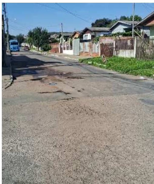
Imagem 13. Vistoria realizada no dia 14/06/2024 na Rua Sérgio Luiz Coutinho Garcia.
