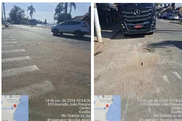
Imagem 09 e 10, Vistoria realizada no dia 14/06/2024 na Avenida João Pessoa.
