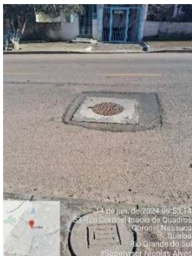
Imagem 07, Vistoria realizada no dia 14/06/2024 na Rua Coronel Inácio Quadros.
