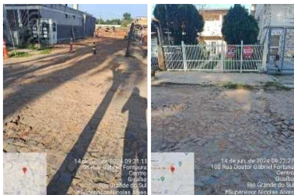
Imagem 03 e 04, Vistoria realizada no dia 14/06/2024 na Rua Doutor Gabriel Fortuna.
