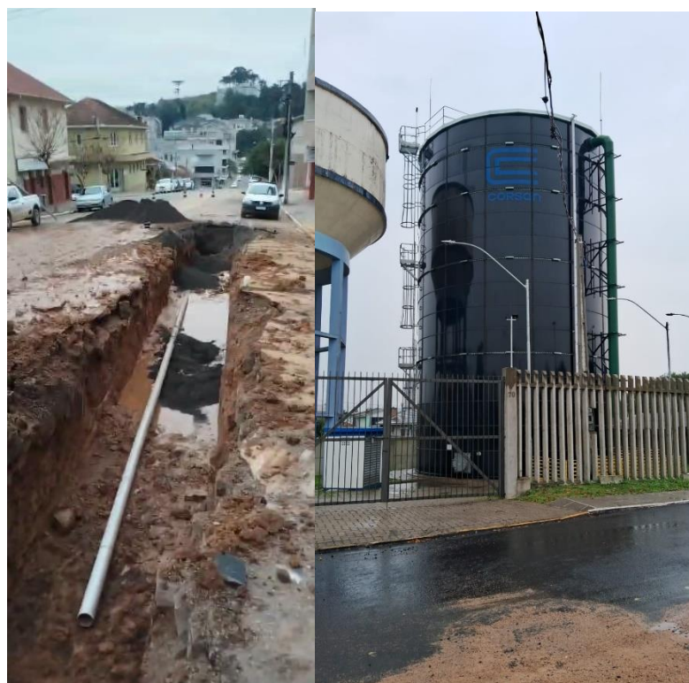
A esquerda, rua Vicenda Dal Bo, a direita o reservatório de 2000000m3
