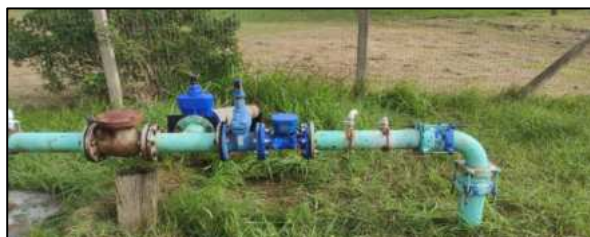
Figura - Macro medidor instalado no barrilete da captação
