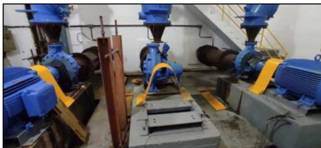
Figura - Bomba principal e reservas instaladas.
