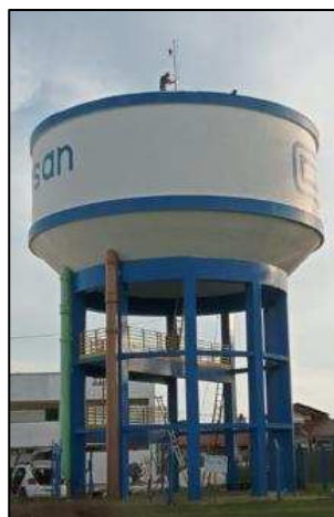
Figura - Reservatório com SPDA instalado
