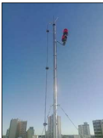
Figura - SPDA instalado no reservatório.
