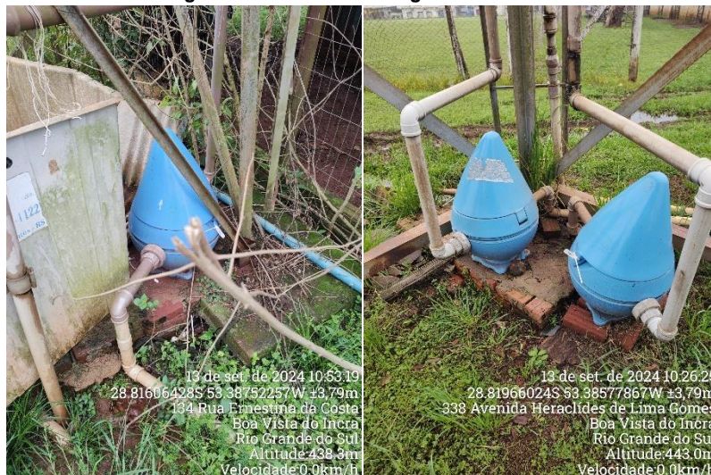
Figura 4 – Tratamento de água subterrânea
