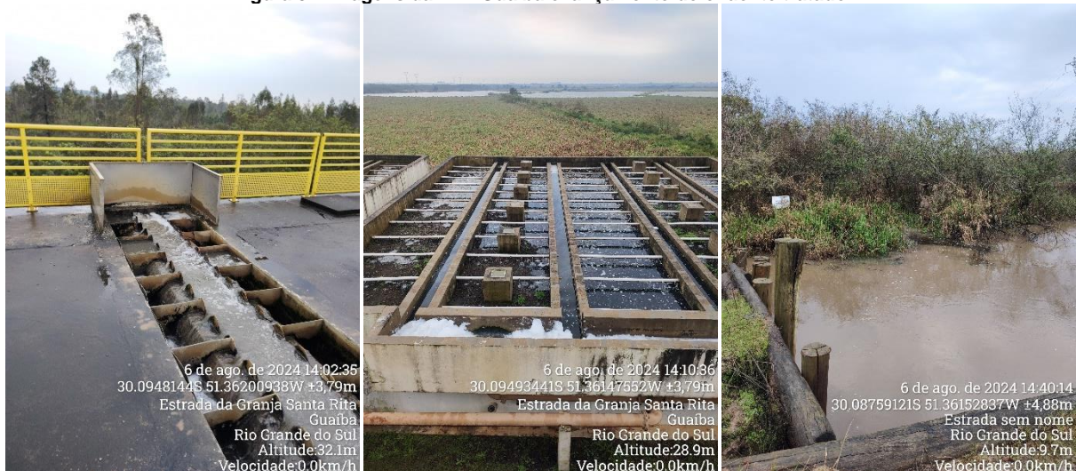
Figura 8 – Imagens da ETE Guaíba e lançamento do efluente tratado.
