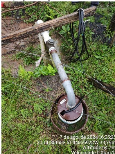
Figura 1 – Poço de captação de água subterrânea do município de Guaíba.
