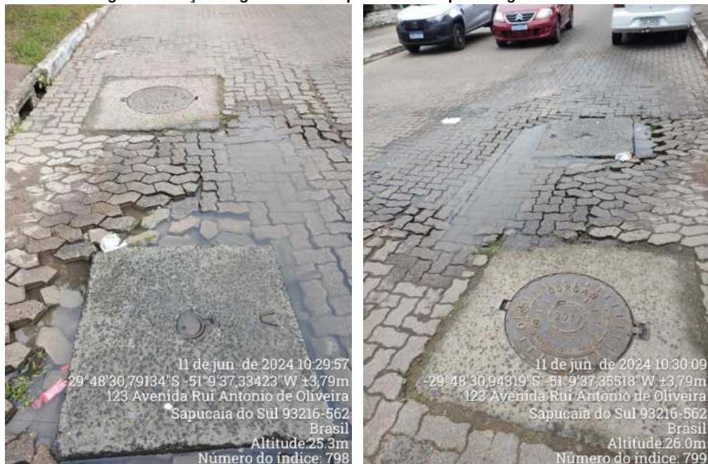
Figura 3 – Poça de água localizada próxima à tampa do registro da EBAT.
