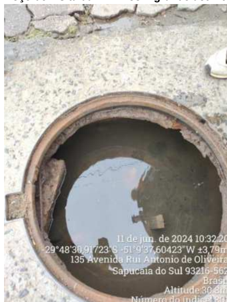
Figura 4 – Poço de visita da EBAT com grande acúmulo de água.
