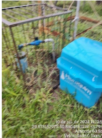
Poço Loteamento Germânia
