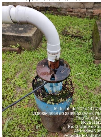
Poço 1 Loteamento Ipê
