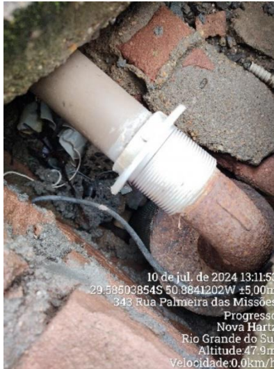
Poço Loteamento Imigrantes
