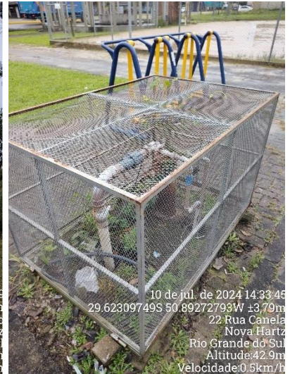
Poço Loteamento Lúcio Campo Vicente
