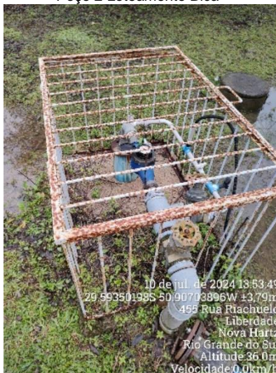
Poço Loteamento Baviera
