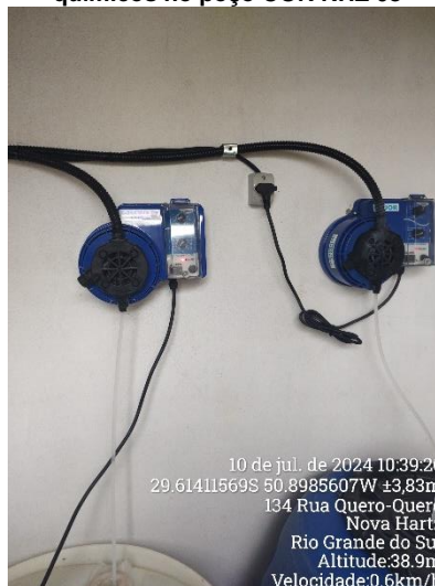
Figura 4 – Cloração e fluoretação por dosagem de químicos no poço COR NHZ 08
