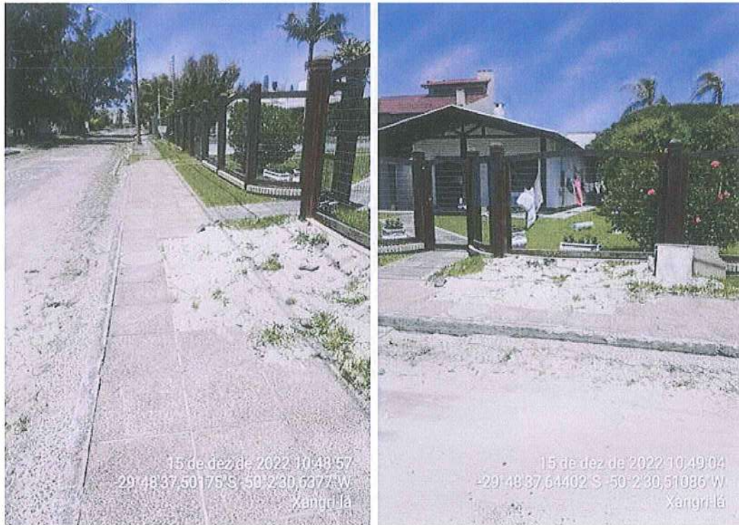
Figura 4 - Registro fotográfico do Ponto 3 na Rua Rio Negro.
