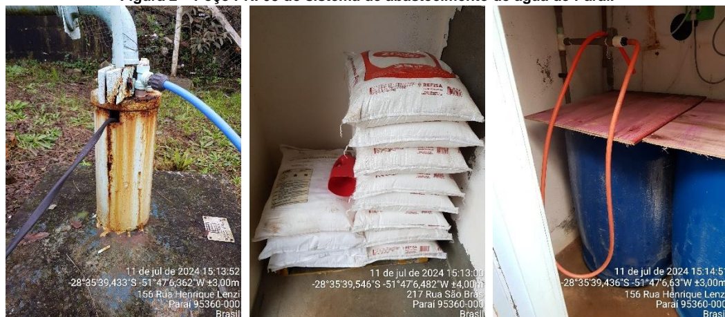
Figura 2 – Poço PRI 05 do sistema de abastecimento de água de Paraí.
