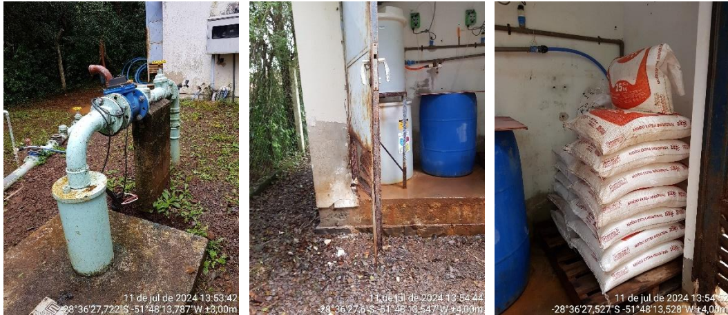
Figura 4 – Poço PRI 06, 11, 16 do sistema de abastecimento de água de Paraí.
