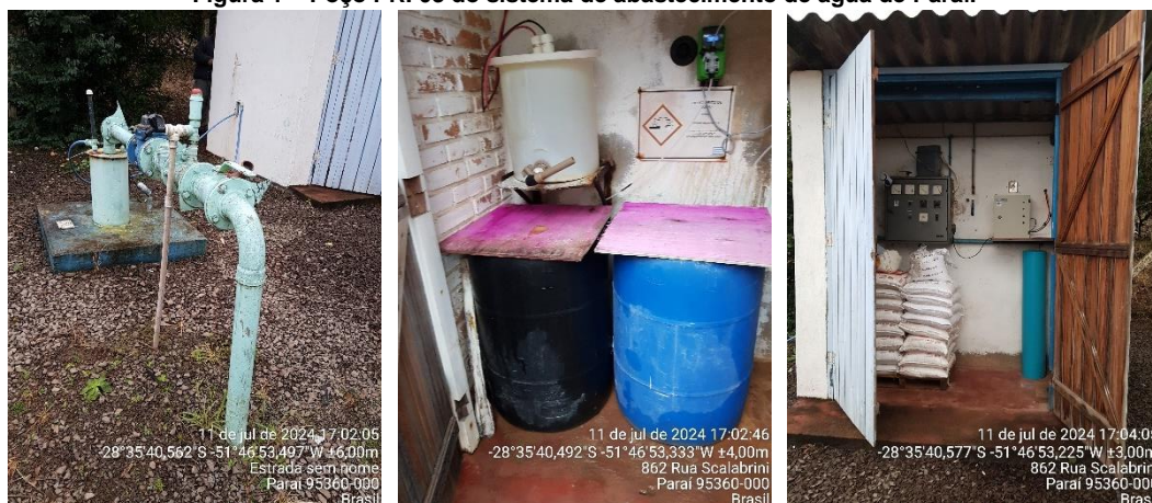
Figura 1 – Poço PRI 03 do sistema de abastecimento de água de Paraí.
