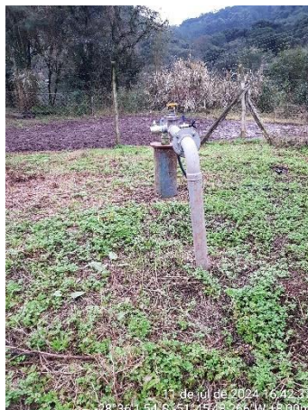
Figura 6 – Poço PRI 31 do sistema de abastecimento de água de Paraí.
