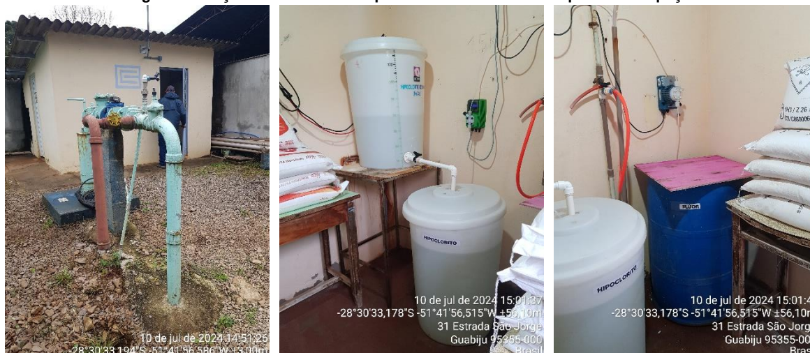
Figura 1 – Poço SJR-05 e casa de químicos do tratamento simplificado do poço.
