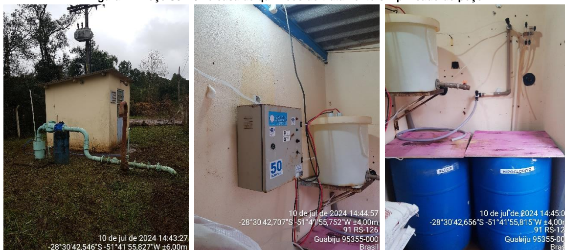
Figura 2 – Poço SJR-07 e casa de químicos do tratamento simplificado do poço.
