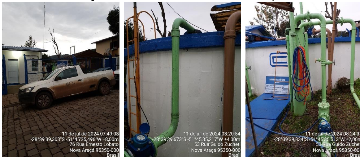
Figura 8 – Unidade de Saneamento da Corsan em Nova Araçá.
