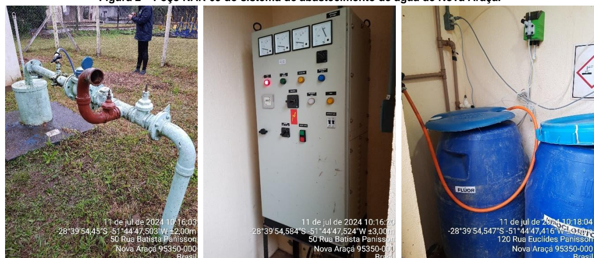
Figura 2 – Poço NAR 09 do sistema de abastecimento de água de Nova Araçá.
