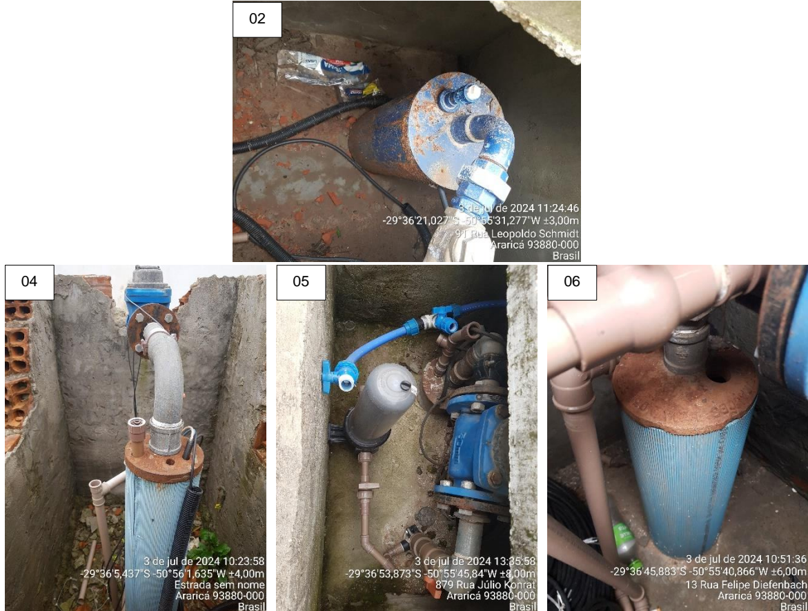
Figura 4 – Poços para abastecimento em Araricá: 02, 04, 05, 06.
