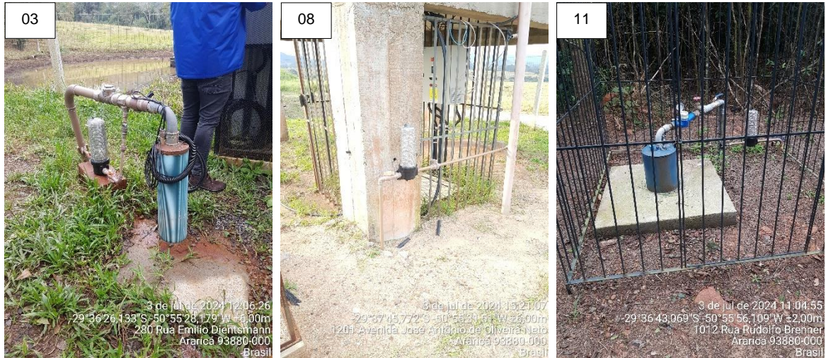
Figura 3 – Tratamento por cloro pastilha nos poços 03, 08 e 11.
