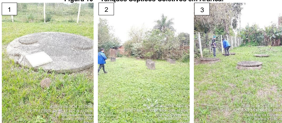
Figura 10 – Tanques Sépticos Coletivos em Araricá.
