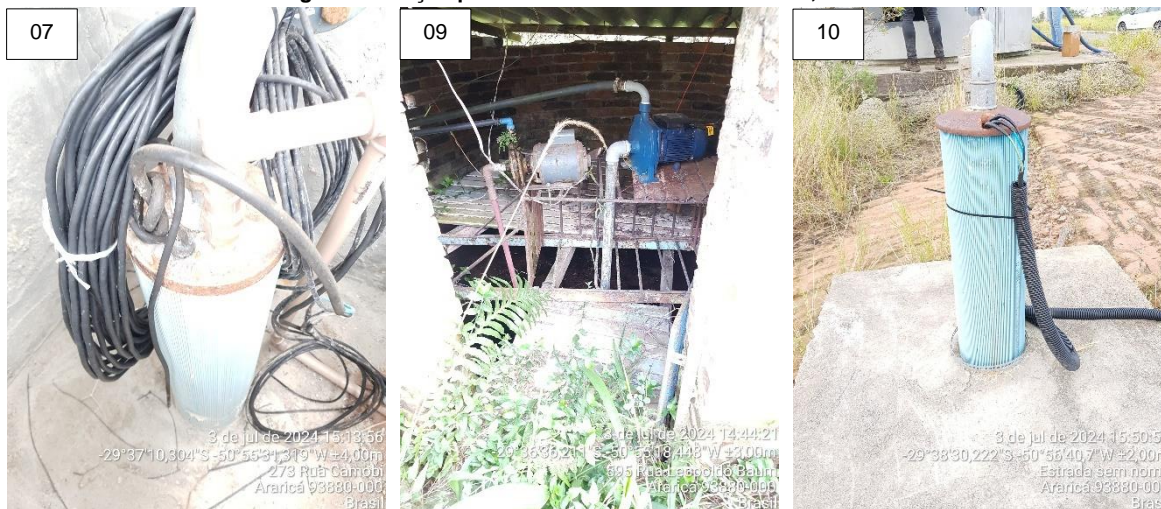
Figura 5 – Poços para abastecimento em Araricá: 07, 09 e 10.
