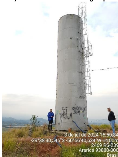
Figura 09 – Reservatório 10 (Bela Vista) de abastecimento de água por caminhão pipa em Araricá.
