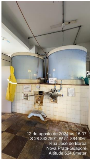
Tanques de sulfato de alumínio
