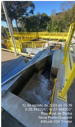
Calha Parshall e Floculador
