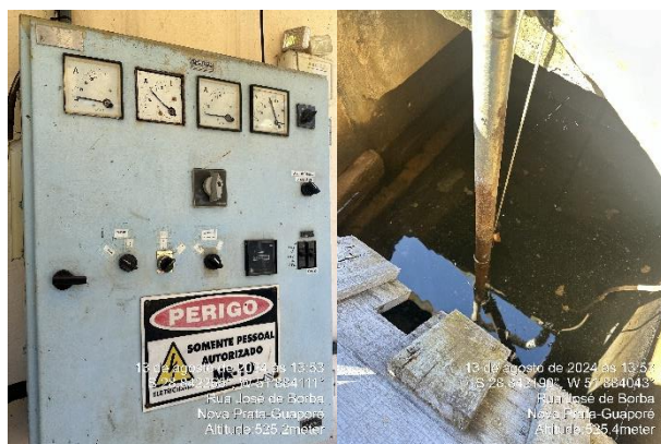
1 Buster do decantador – ETA
