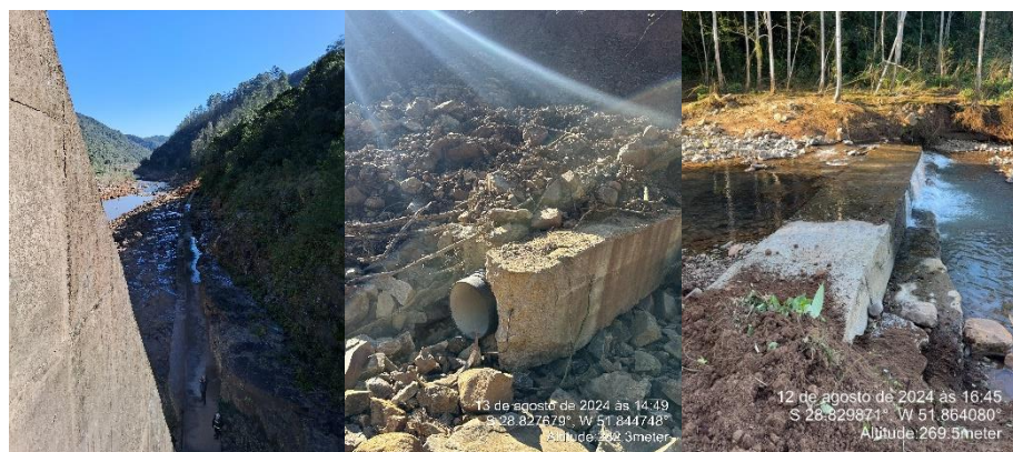
Tubulação de adução da água bruta
