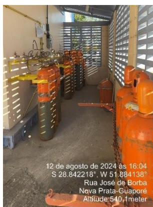
Armazenamento do gás cloro
