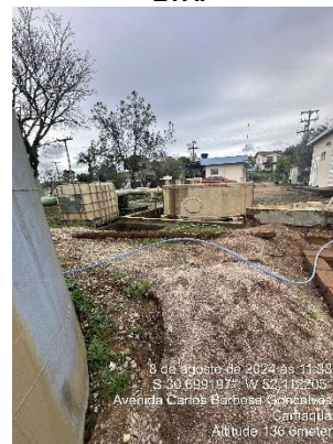
Figura 8 – Material sedimentar disposto no terreno na ETA.
