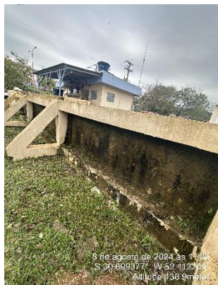
Figura 7 – Infiltrações da estrutura do decantador.
