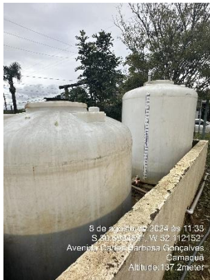
Tanques de sulfato de sódio
