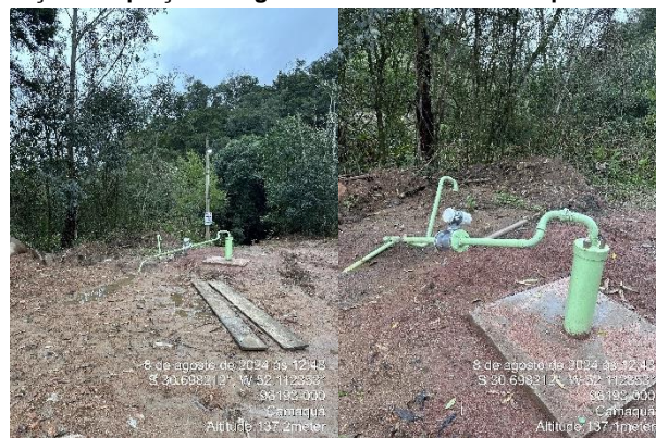
Figura 4 – Poço de captação de água subterrânea do município de Dom Feliciano.
