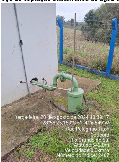
Figura 4: Poço de captação subterrânea de água em Cotiporã.
