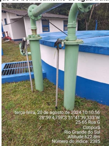
Figura 8: Estação de bombeamento de água tratada em Cotiporã.
