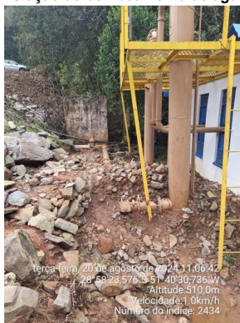
Figura 7: Estação de bombeamento de água bruta em Cotiporã
