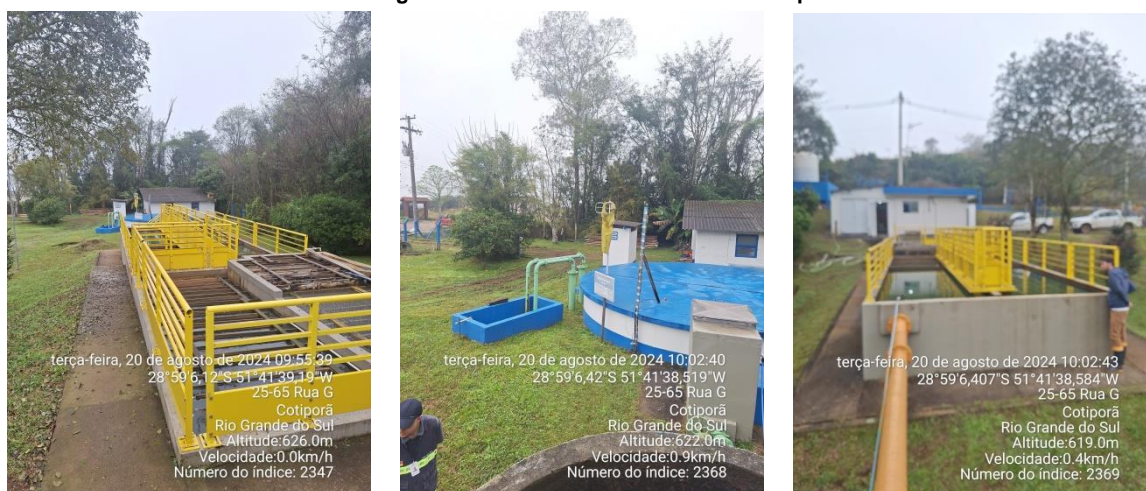
Figura 6: Bloco hidráulico da ETA de Cotiporã
