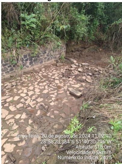
Figura 3 – Rompimento de estrutura da barragem do sistema de abastecimento de água de Cotiporã
