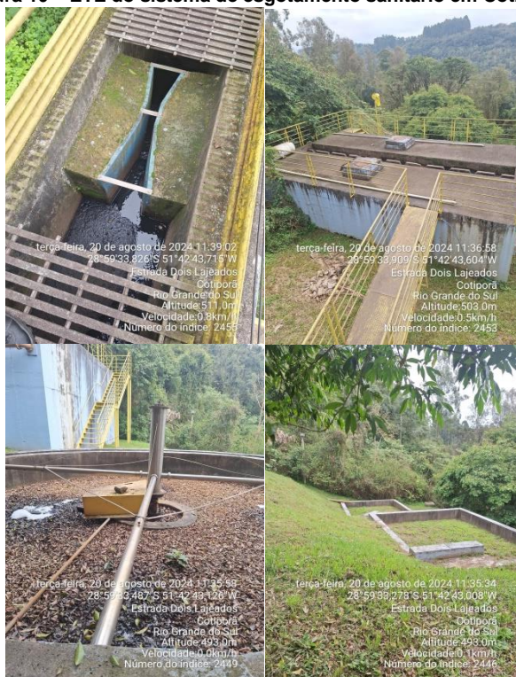
Figura 10 – ETE do sistema de esgotamento sanitário em Cotiporã.
