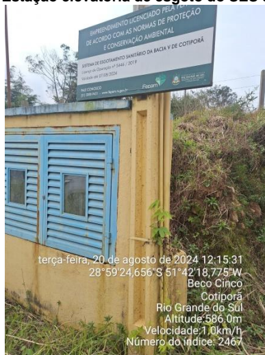
Figura 12: Estação elevatória de esgoto do SES de Cotiporã.
