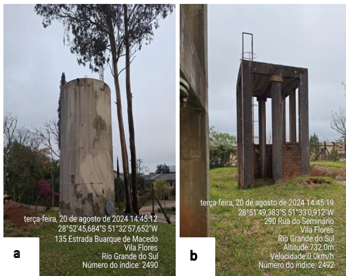
Figura 2: Reservatórios desativados em Vila Flores. a) Reservatório desativado; b) Base para dispor reservatório não sendo utilizada.
